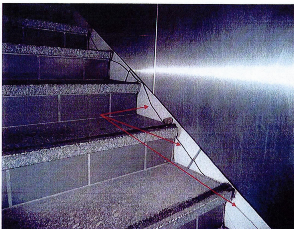
Voie 2 : Côté droit escalier – Fissure
