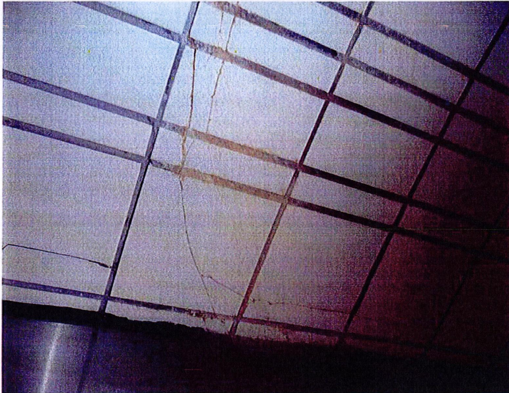
Voie 1 : Point 1 – Fissuration
