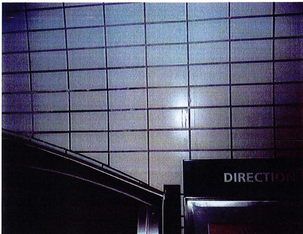
Voie 2 : Point 3 – Efflorescence
