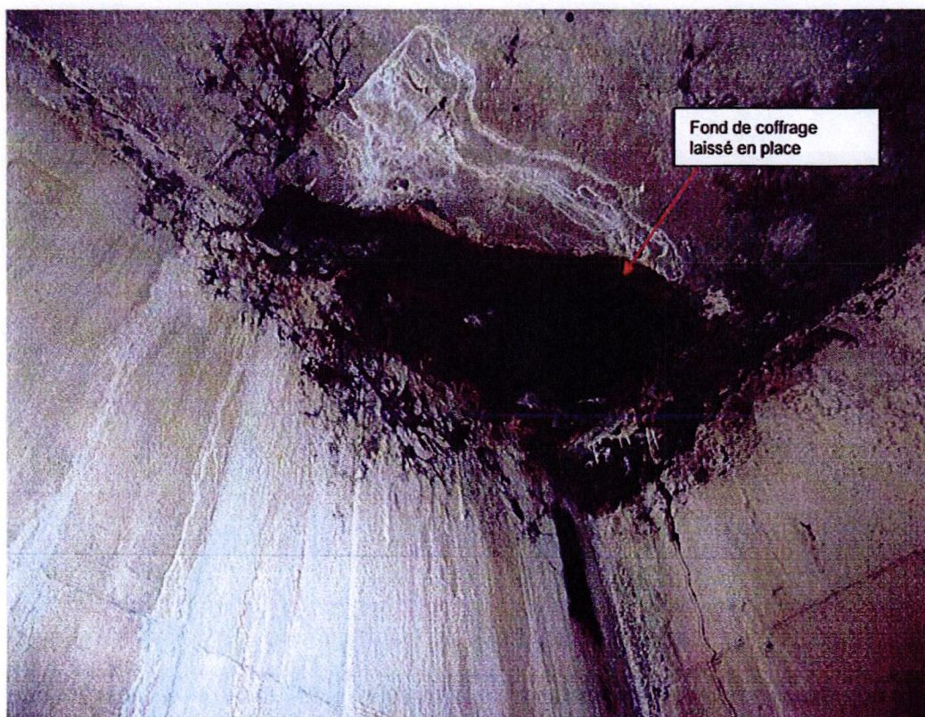
Local : Détail (A) sur plafond avec efflorescences
