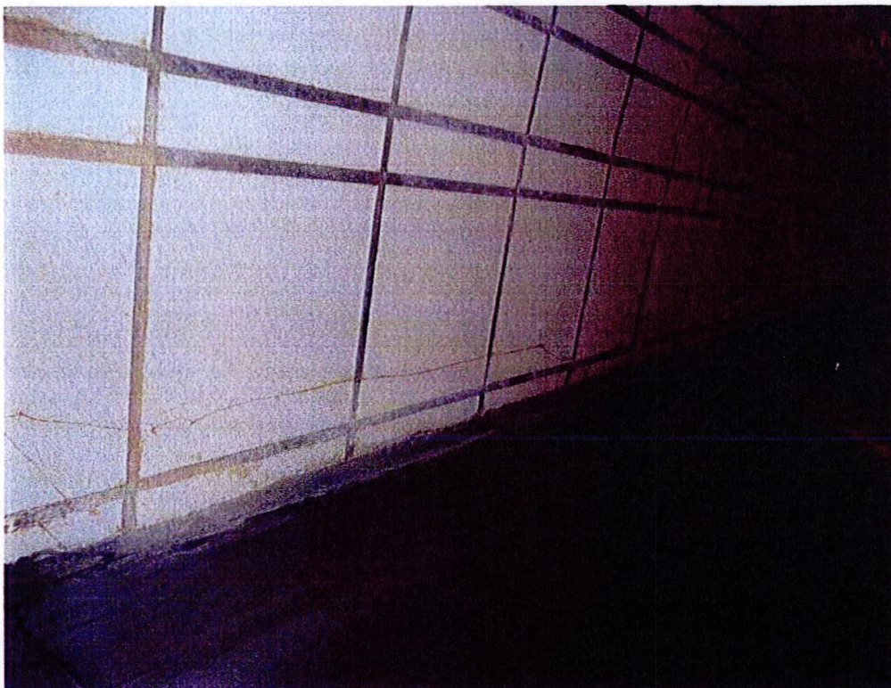
Voie 1 : Point 2 – Fissuration
