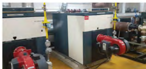
Chaufferie de Langlade
