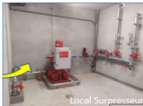
Lutte Risque Incendie
